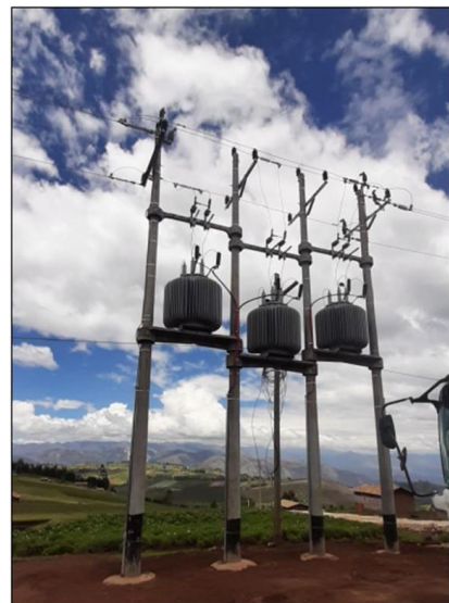
Fig. 04 Sistema de Regulación de tensión
